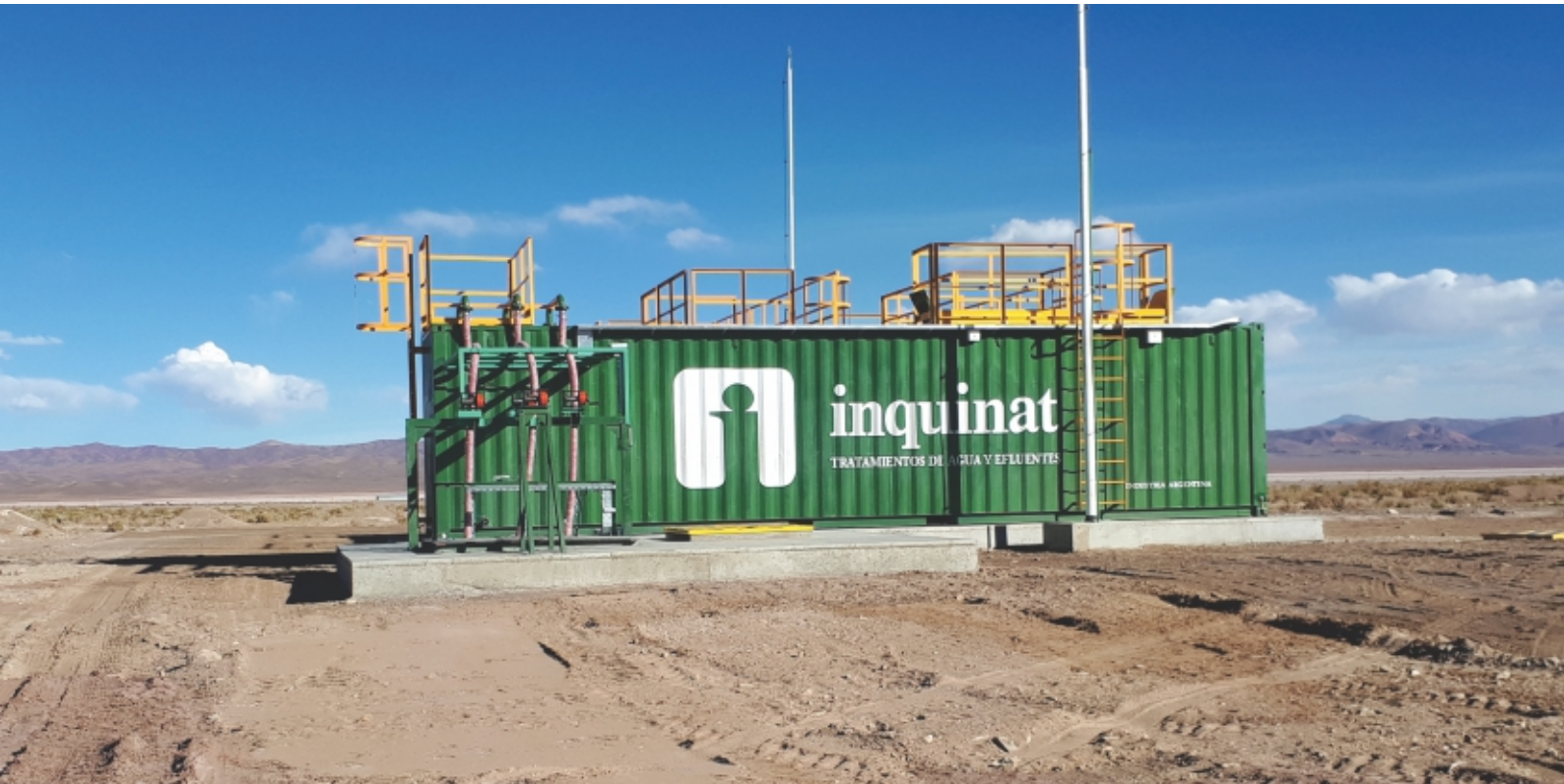
Planta de Tratamiento de Efluentes cloacales / Ene20
