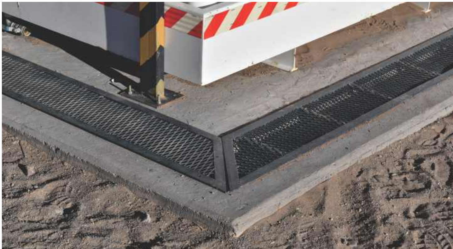
Instalaciones provistas de canaletas para contención de derrames y Kit de elementos de contención de derrames Spill Kit.
